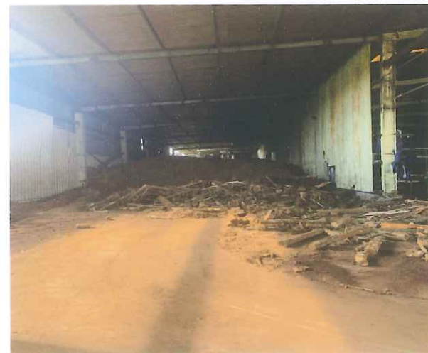
Kho chứa mùn cưa, gỗ bìa để đốt lò
