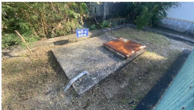
Bể chứa bùn
