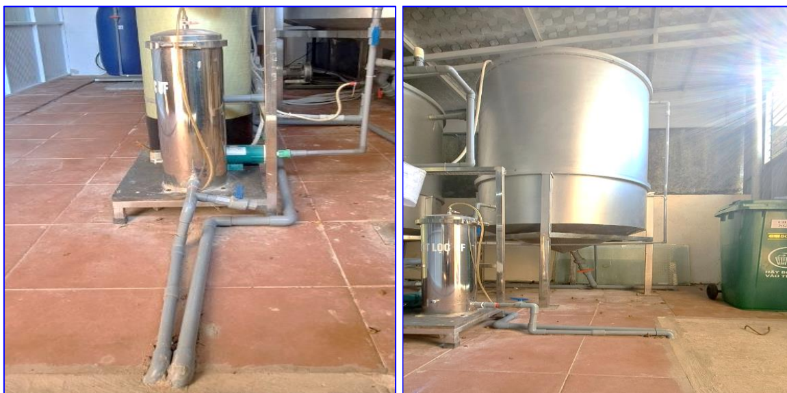
Hình 16: Vị trí xả nước thải tại Cơ sở
