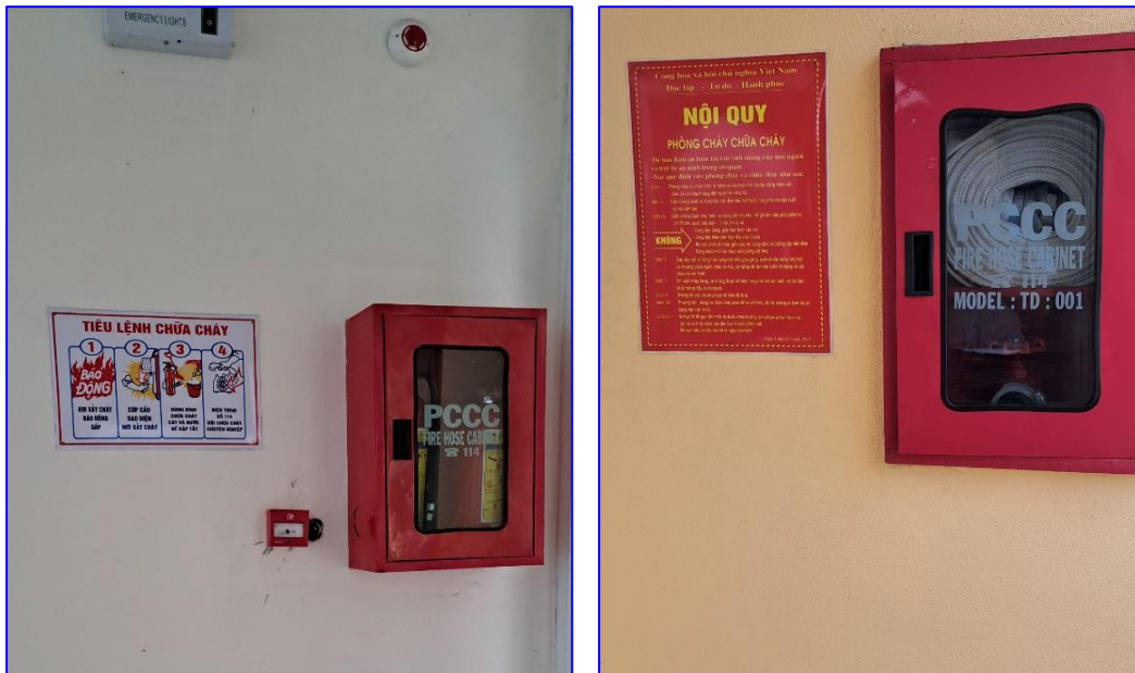
Hình 15: Hệ thống phòng cháy, chữa cháy tại Cơ sở
