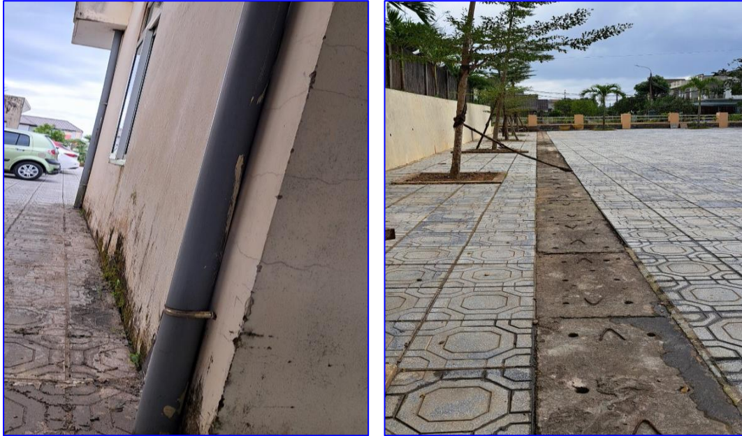
Hình 4: Hệ thống thu gom, dẫn nước mưa của Cơ sở
