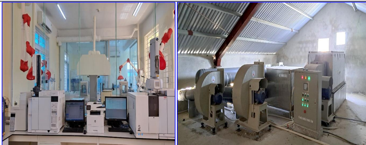
Hình 11: Hệ thống xử lý khí thải tại Cơ sở
