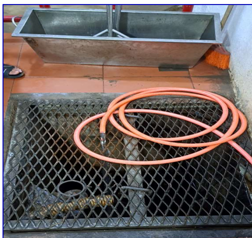
Bể gom nước lẫn dầu mỡ ri
