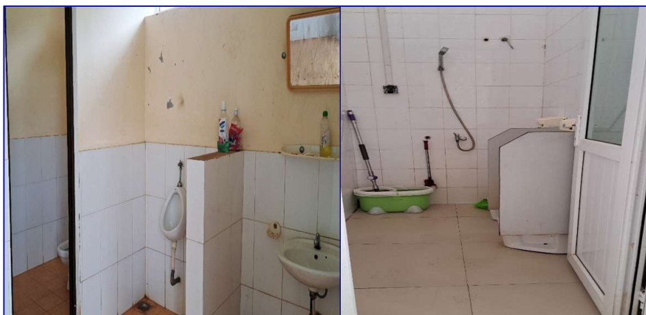
Hình 11: Hệ thống nhà vệ sinh tại các khu vực
