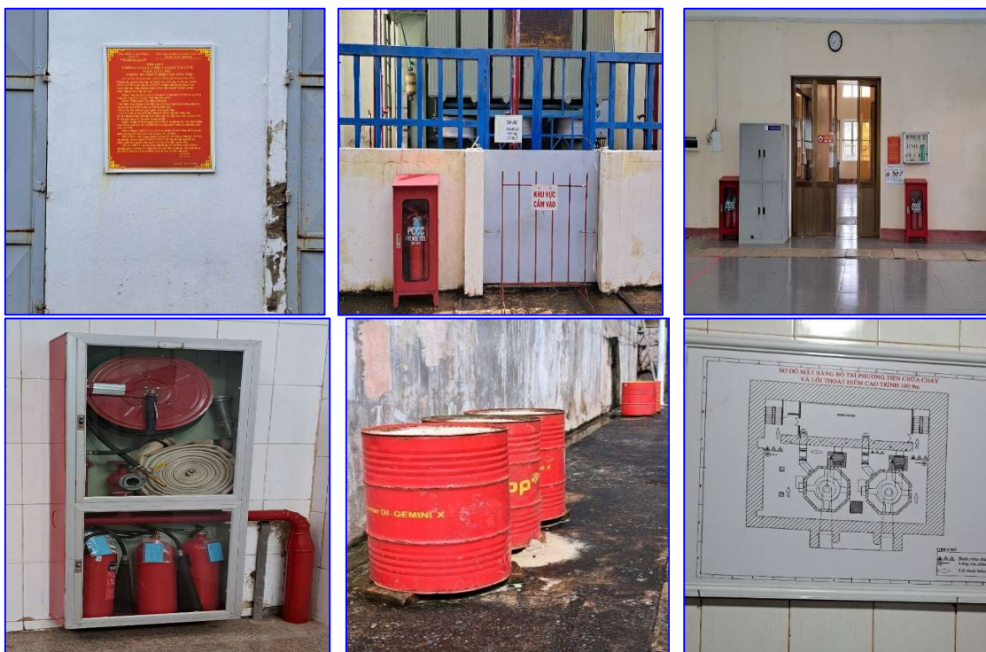
Hình 15: Các công trình và biện pháp PCCC tại Cơ sở
