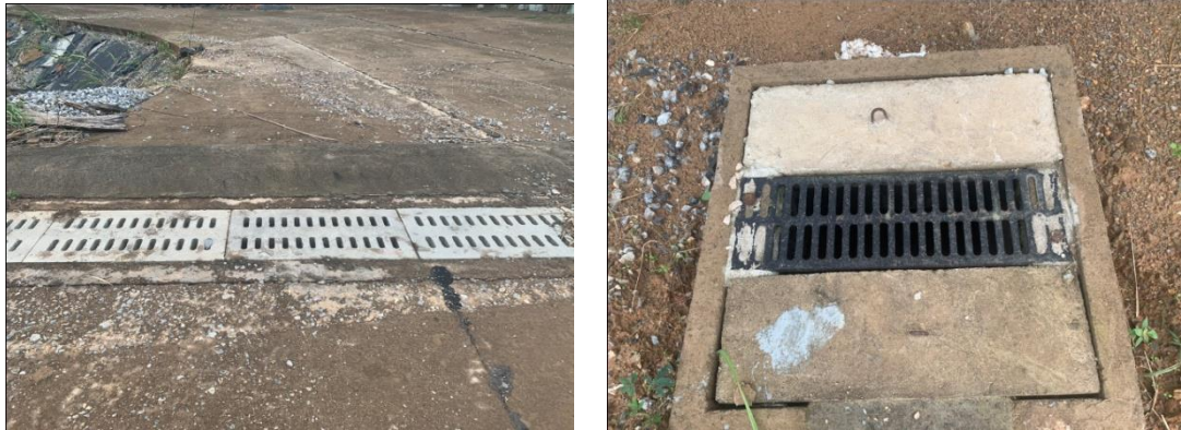
Hình 3.1. Hình ảnh rãnh thoát, hố ga thu gom, thoát nước mưa
