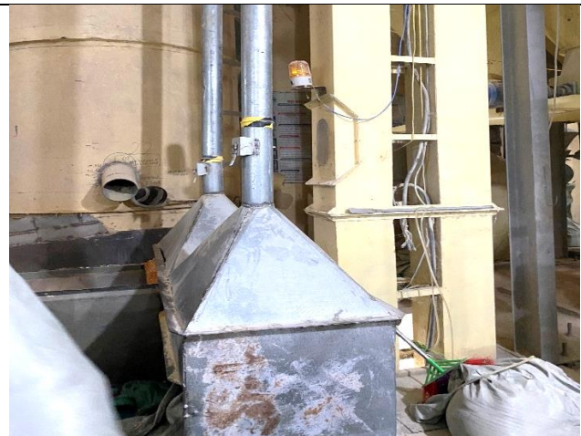
Hệ thống chụp hút thu gom bụi
