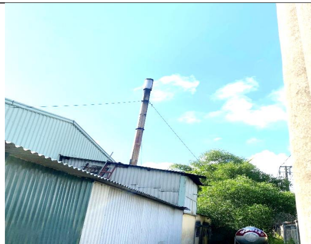
Ống khói lò hơi
