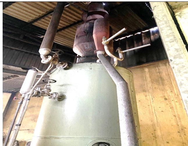
Hệ thống xử lý khí thải lò hơi đốt than
