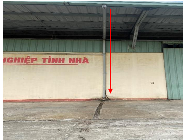
Ống nhựa PVC thu nước từ mái nhà
