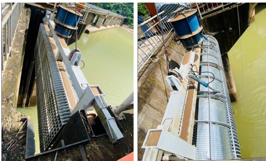
Hình 3.5. Máy vớt rác tại đập dâng Thủy điện Đa Krông 1
