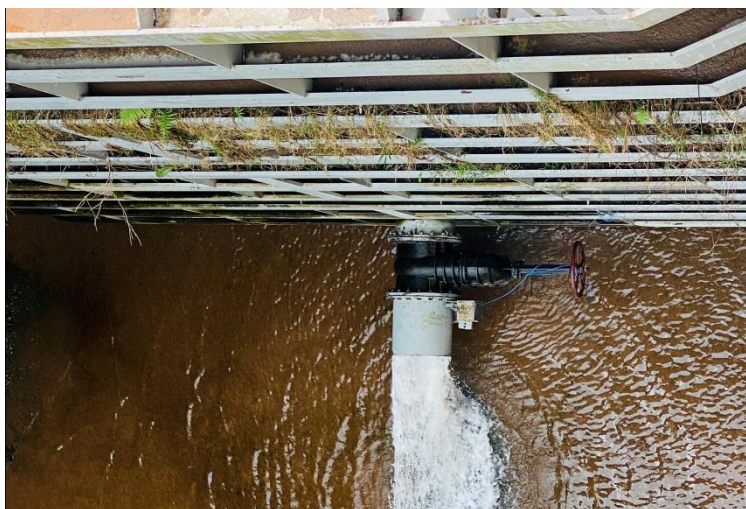
Hình ảnh 3.9. Cổng xả dòng chảy tối thiểu tại đập thủy điện Đa Krông 1
