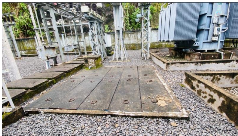
Hình 3.4. Hố thu dầu sự cố tại Trạm biến áp ngoài trời 6,3/35kV
