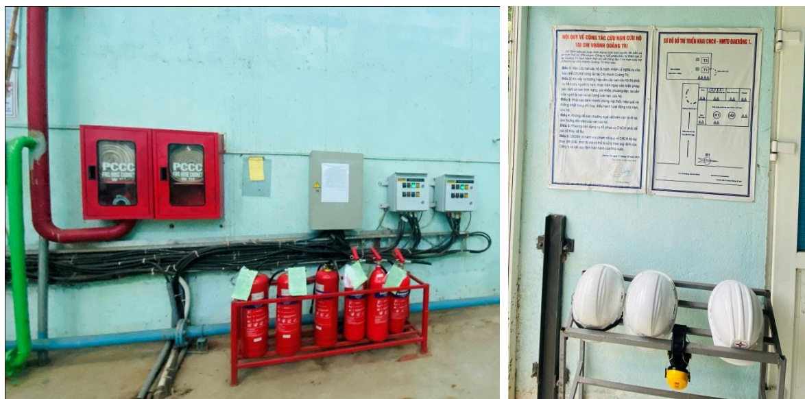
Hình ảnh 3.7. Thiết bị phòng cháy chữa cháy tại Cơ sở
