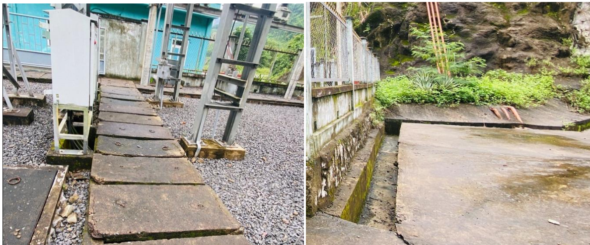
Hình 3.2. Mương thu gom nước mưa khu vực trạm biến áp và nhà vận hành
