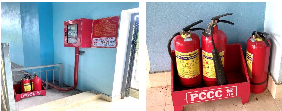
Hình 3.8. Thiết bị phòng cháy chữa cháy tại Cơ sở
