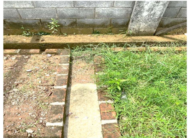
Cống, rãnh bê tông ở nhà làm việc
