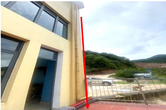
Ống nhựa PVC thu nước từ mái nhà
