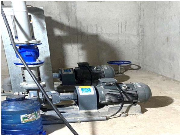
Hệ thống bơm tại bể tách dầu 2 ngăn
