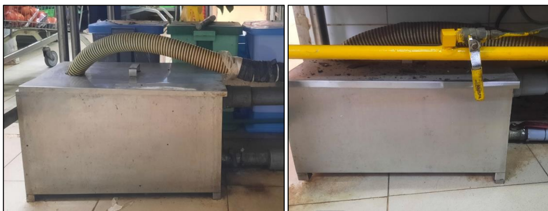
Hình 3.4. Hình ảnh thực tế hệ thống tách dầu mỡ sơ bộ
