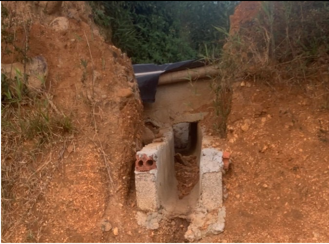
Mương thoát nước mưa
