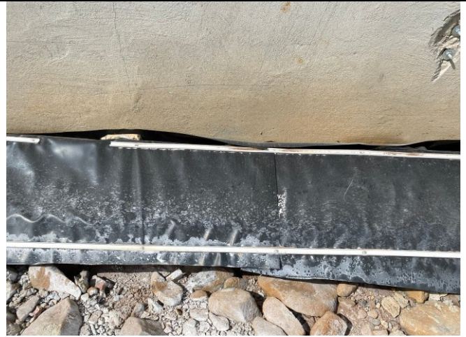
Mương thu gom nước thải
