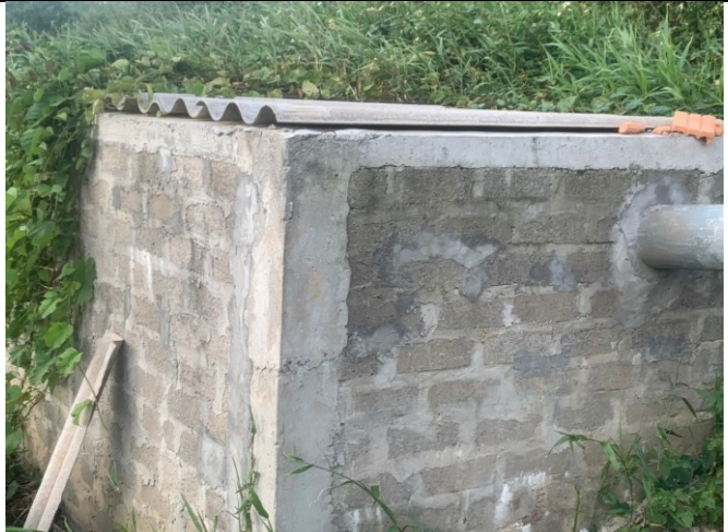
Bể gom nước thải
