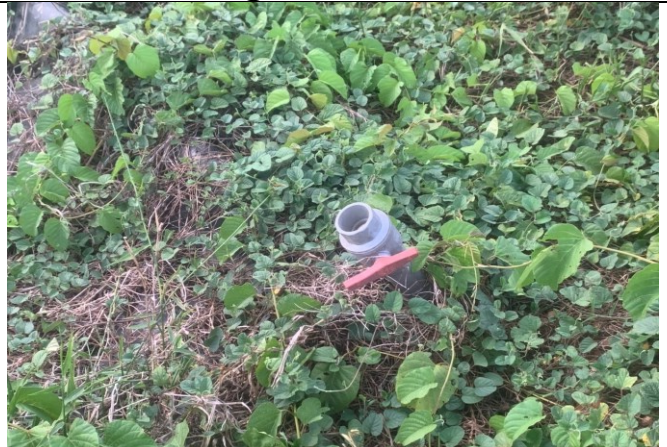
Van xả khí hầm biogas
